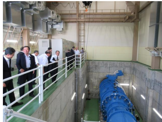
H30.07.18 団体営地域用水環境整備事業「庄西幹線用水地区」(小水力発電事業)竣工修祓式
